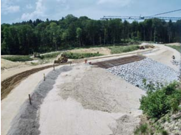
14: Die Dammschüttung im fortgeschrittenen Stadium. Die Zonierung des Stützkörpers ist deutlich erkennbar. Beim dunkelgrauen Material handelt es sich um die unterwasserseitige Filterschicht aus Kiessand.
