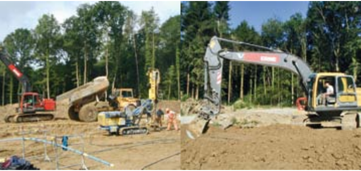
10: Links im Vordergrund: Injektionsarbeiten an der Dammaufstandsfläche. Rechts Arbeiten an einer Probeschüttung.
