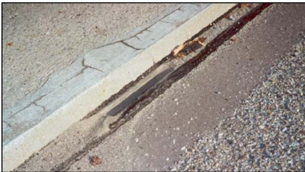
Abbildung 4: Risse zwischen Reprofilierungsmörtel und Betonuntergrund ermöglichen das Eindringen von Wasser
