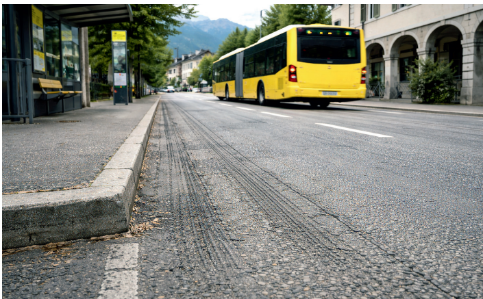
Spurrinnenbildung im Haltestellenbereich infolge hoher Achslasten sowie wiederholter Brems- und Beschleunigungsvorgänge. (Foto: KI)
